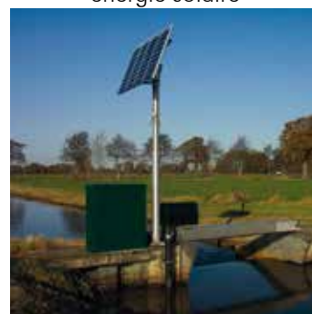
Alimentation servomoteur par énergie solaire
